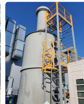
흡수에 의한 시설 배출가스 중의 오염물질과 물과의 기액 접촉에 의해 수용성 물질을 처리
